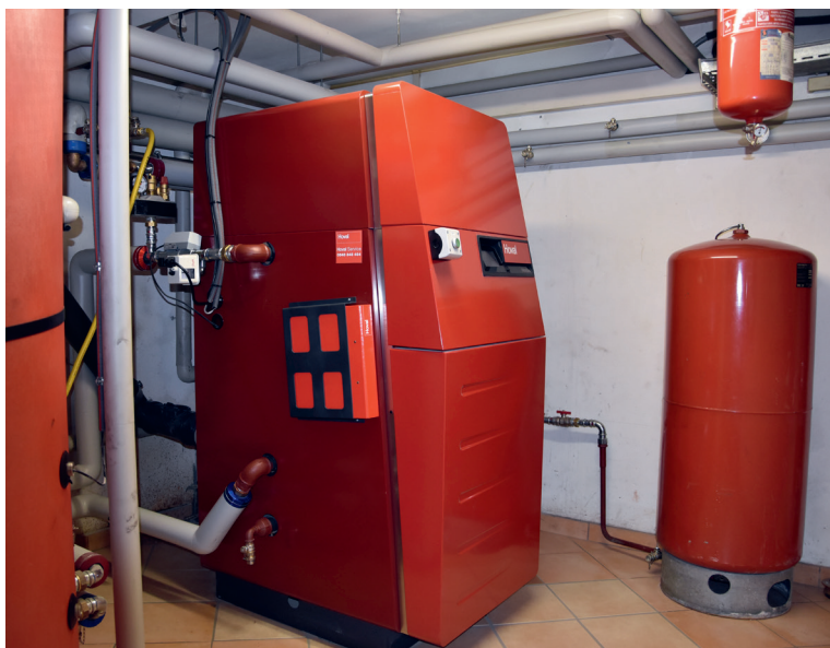
La nouvelle installation de chauffage avec chaudière à gaz.
